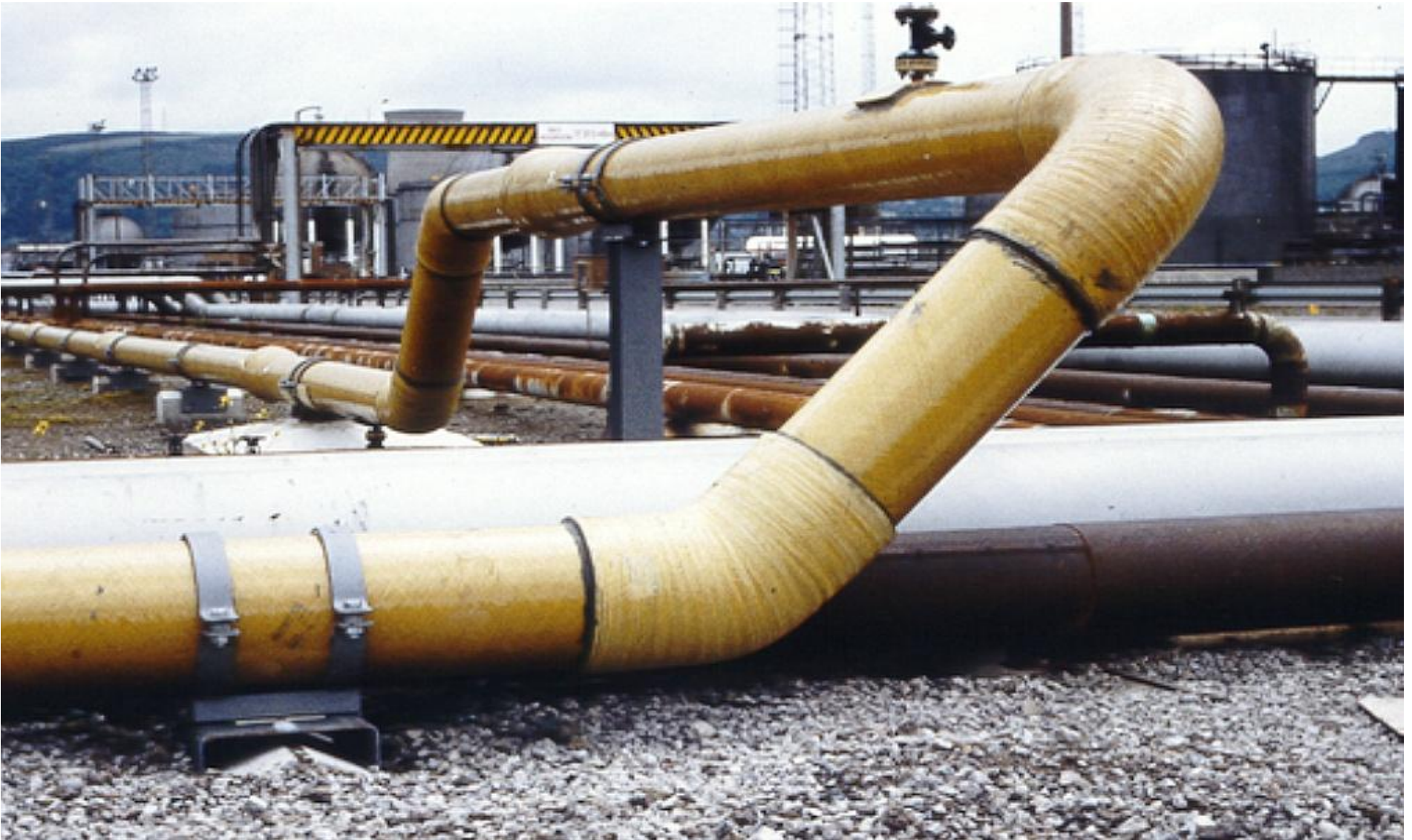
Effluent lines – BP U.K.
