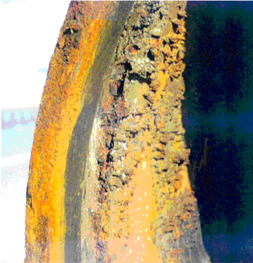
Distrugerea in interior a tevilor din otel
