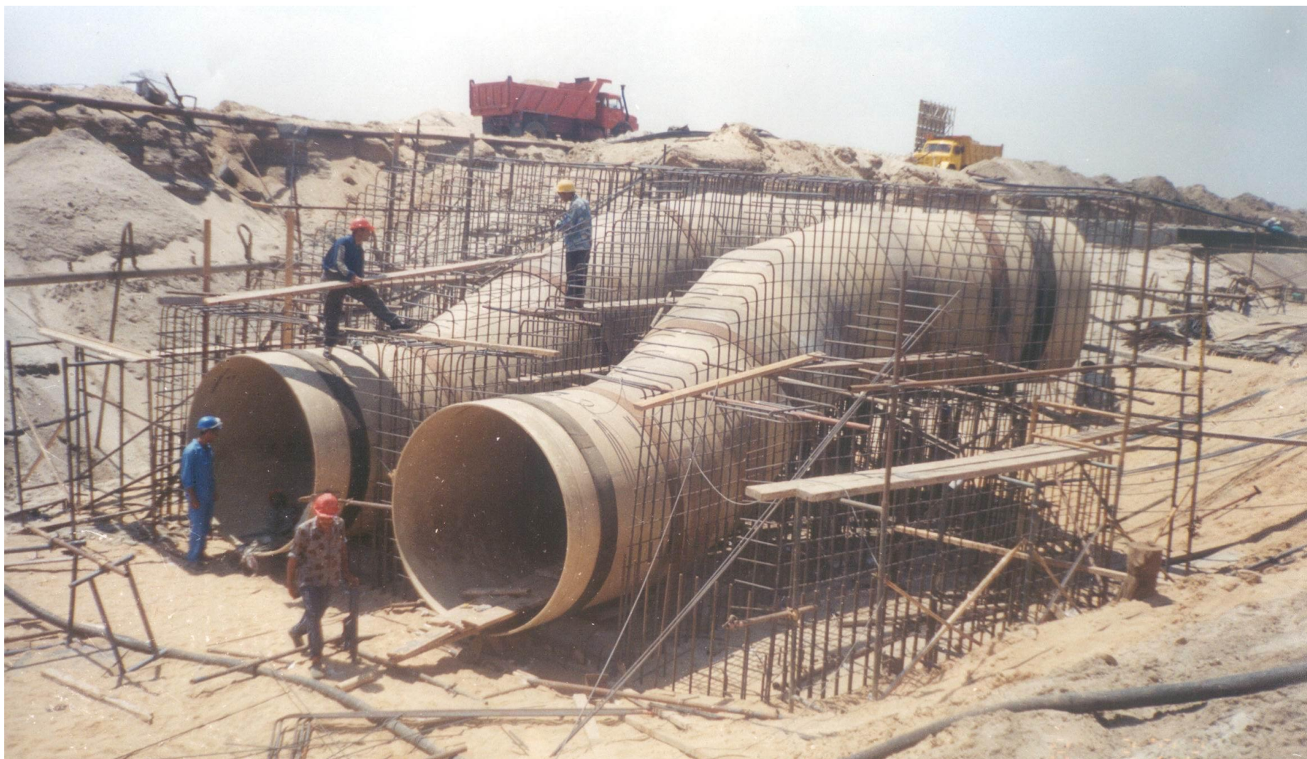
Sistem de tevi Fiberstrong® (tip PAFSIN) montat subteran, cu blocuri de ancorare din beton, la schimbarea directiei
